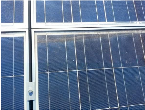
Foto del modulo
