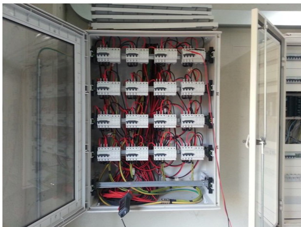
Quadro sezionatori di stringa
