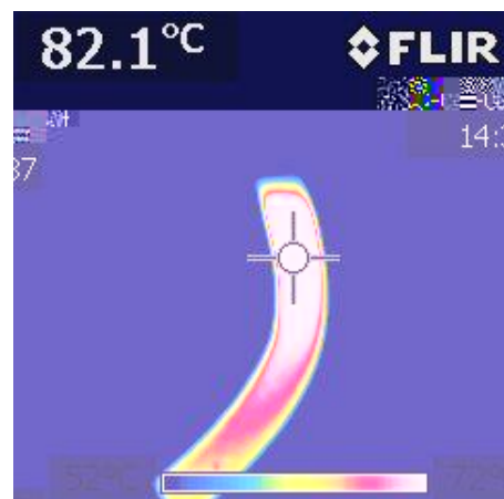
Cavo non ben crimpato nel connettore: temperatura eccessiva
